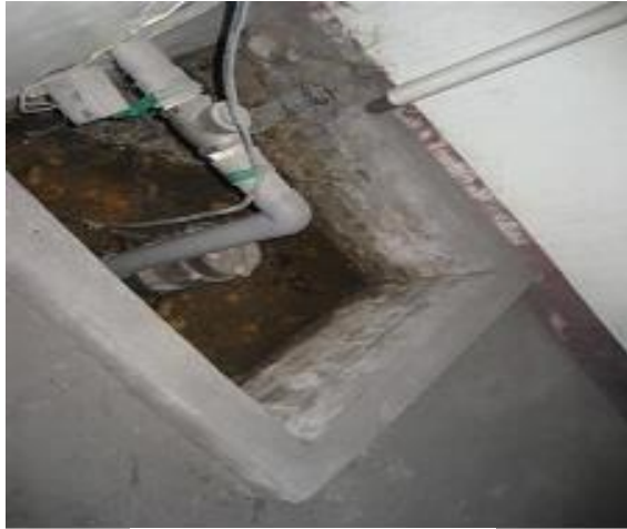
地下室儲水槽
