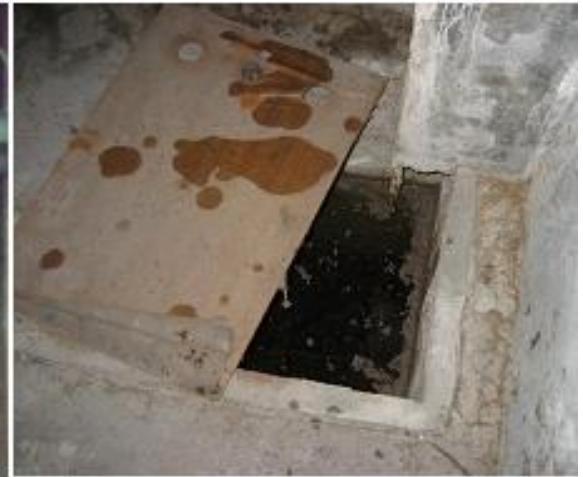
地下室汗水池
